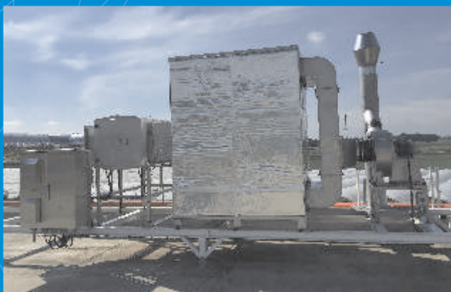
Instalacja oczyszczanie powietrza wywiewanego Centriair o wydajności 3000 m 3 /h z reaktorem UV oraz filtrem z węglem aktywnym
