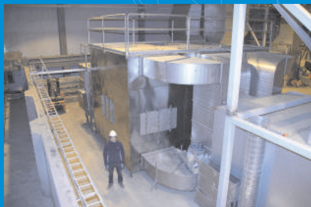
Instalacja oczyszczanie powietrza wywiewanego Centriair o wydajności 72 000 m 3 /h z reaktorem UV oraz filtrem z węglem aktywnym
